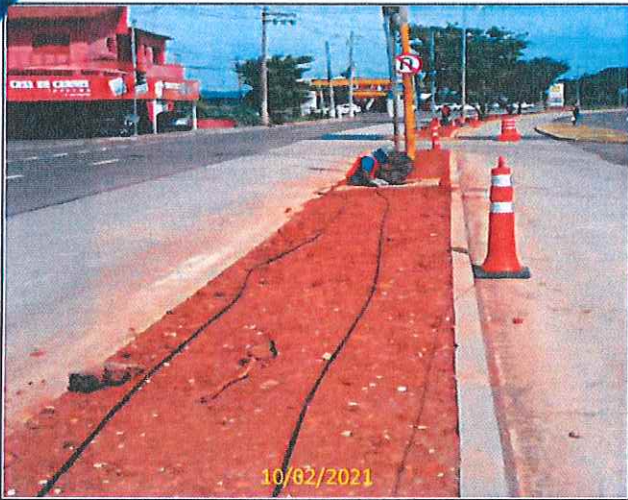
Foto 11 Passagem dos cabos de fibra ótica nas caixas RM
