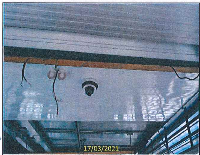
Foto 34 Instalação da câmeras de monitoramento interno (CFTV)
