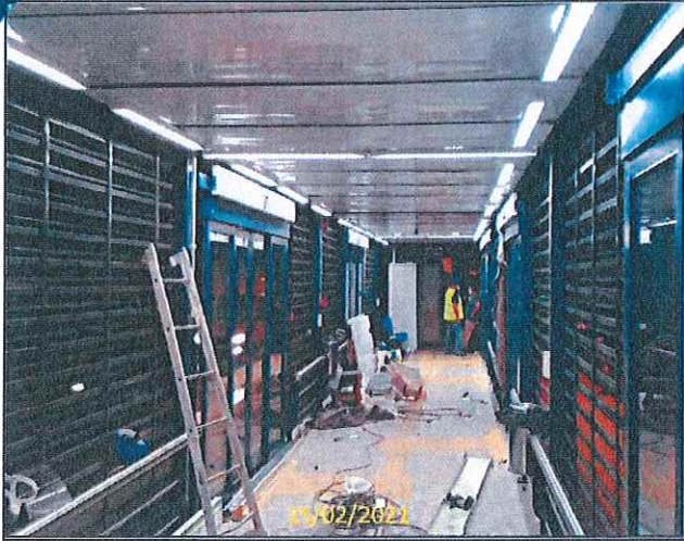
Foto 17 Teste de iluminação da estação
