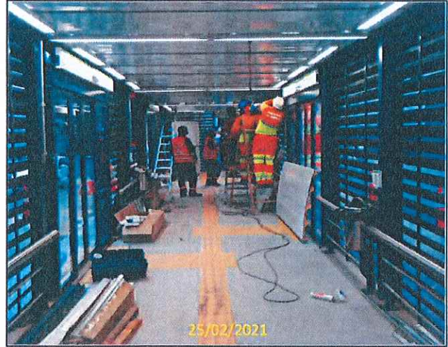
Foto 18 Teste de iluminação da estação
