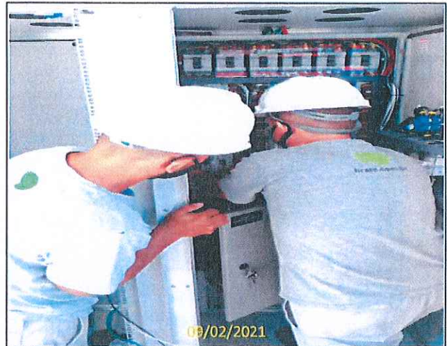
Foto 06 Configuração do cabeamento estruturado no Rack da estação
