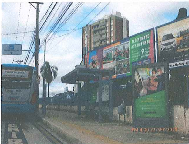
Foto 5: Sistema ITS instalado nos pontos de parada do Corredor Estrutural Sul (S3S).
