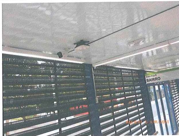
Foto 49: Instalação dos roteadores de WiFi nas estações do Corredor Ipanema.
