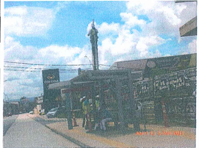
Foto 2: Instalação dos itens do sistema ITS no Corredor Estrutural Área Central.
