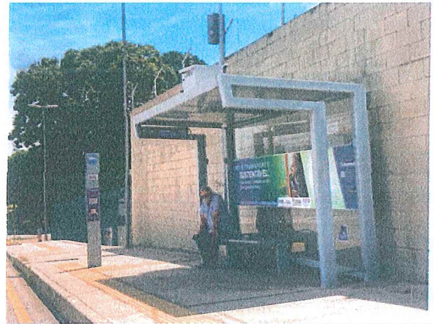
Foto 48: Sistema de ITS instalado no ponto de parada LG01N.
