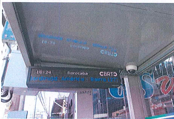
Foto 18 Vista do abrigo da parada AC11 com PMV display e câmera
