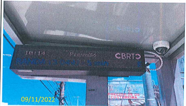
Foto 51 Vista do abrigo da parada ACN2 com PMV display e câmera
