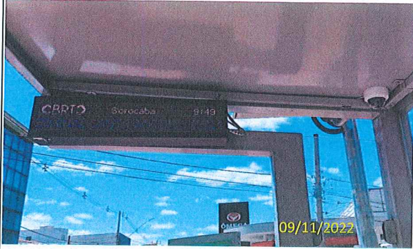
Foto 44 Vista do abrigo da parada ANC1 com PMV display e câmera
