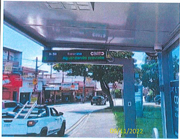
Foto 45 Vista do abrigo da parada ANC2 com PMV display e câmera
