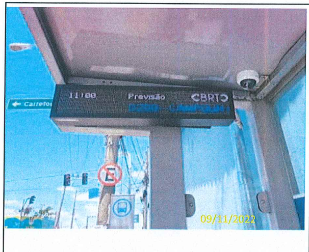
Foto 35 Vista do abrigo da parada LG02C com PMV display e câmera
