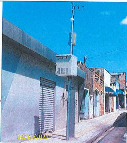
Foto 48 Poste do abrigo da parada ANC4 com Rack.
