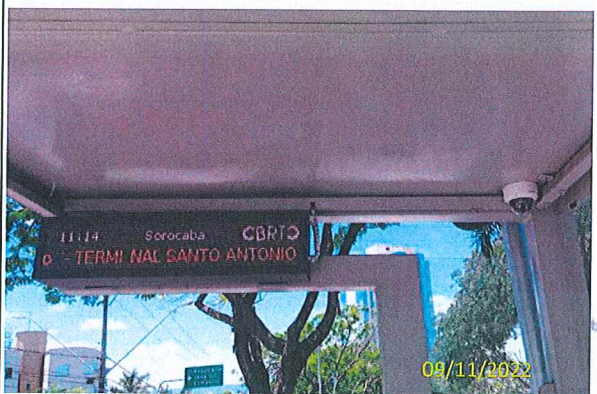
Foto 38 Vista do abrigo da parada LG03C com PMV display e câmera
