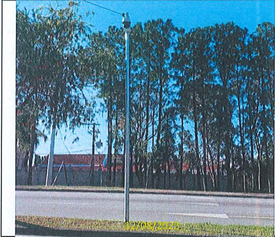
Foto 18 Câmera de via - Dome AV. São Paulo, 5238 - 5237
