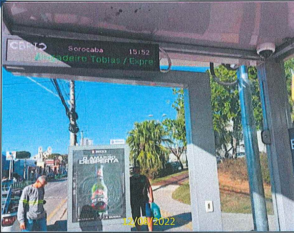
Foto 05 Vista do abrigo da parada L03L com PMV display e câmera.
