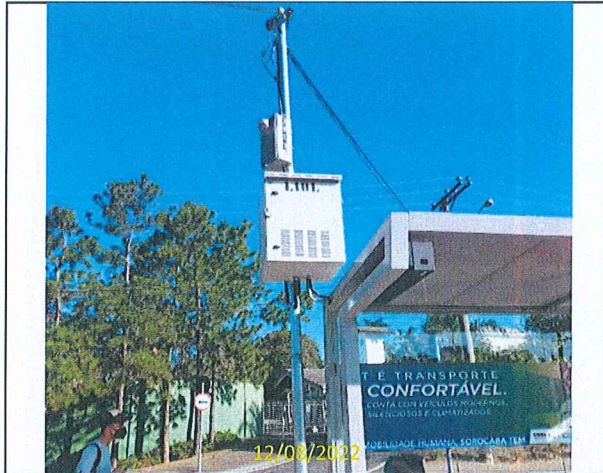
Foto 12 Poste do abrigo da parada L10L com Rack.
