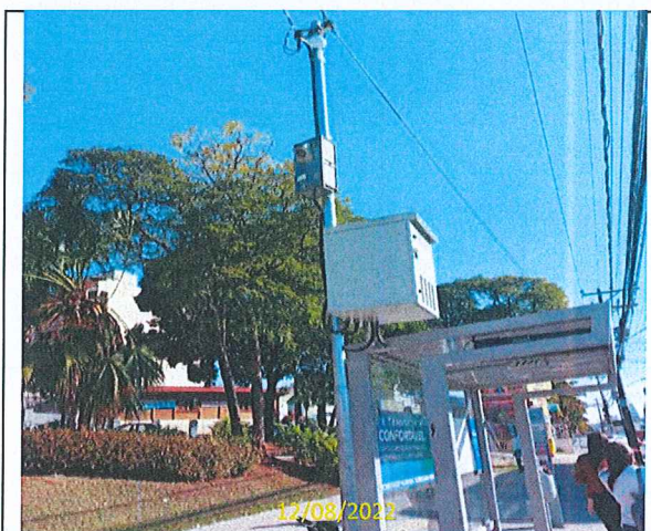
Foto 04 Poste do abrigo da parada L03L com Rack.
