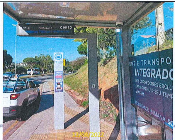
Foto 15 Vista do abrigo da parada L14L com PMV display e câmera.
