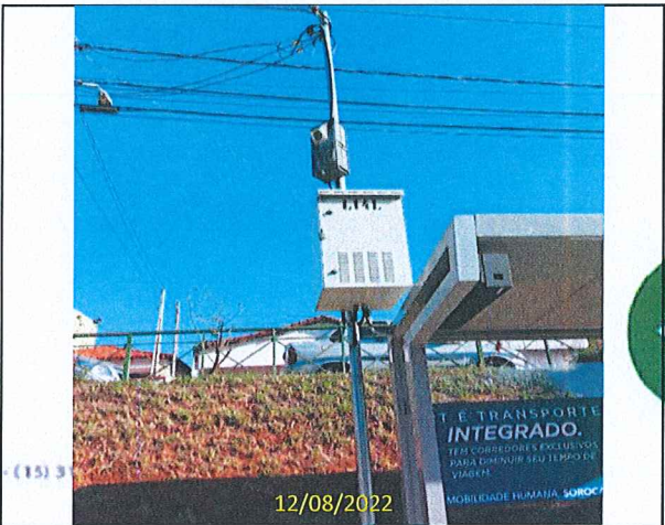
Foto 16 Poste do abrigo da parada L14L com Rack.
