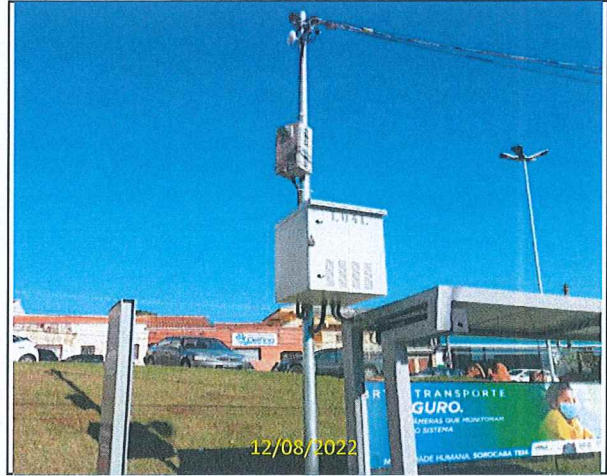
Foto 06 Poste do abrigo da parada L04L com Rack.
