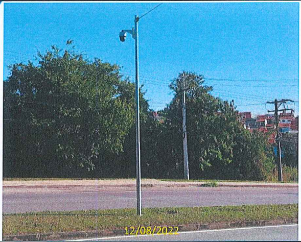
Foto 17 Câmera de via - Dome AV. São Paulo, 3998 - 4001
