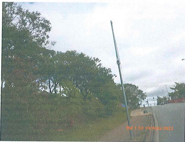
Foto 65: Câmeras fixas de monitoramento de via instaladas no Corredor Estrutural Leste.
