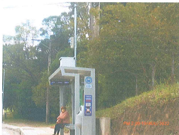
Foto 48: Sistema de ITS instalado no ponto de parada L15L.
