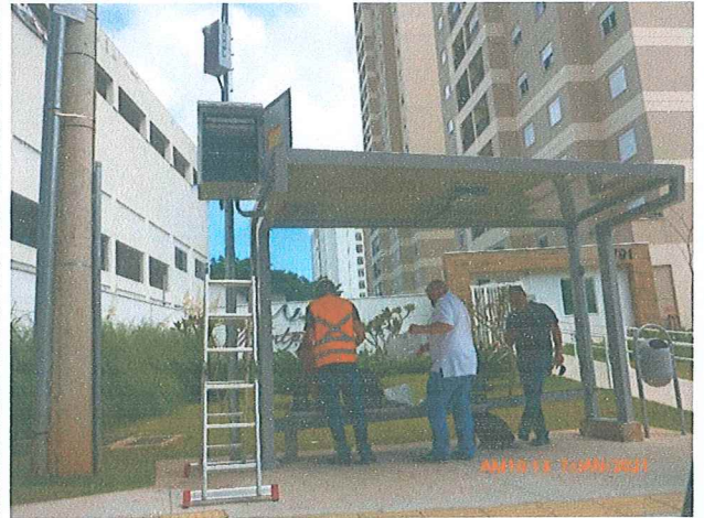
Foto 2: Instalação dos itens do sistema ITS no Corredor Estrutural Leste.
