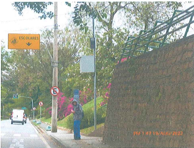
Foto 13: Sistema de ITS instalado no ponto de parada L6L.
