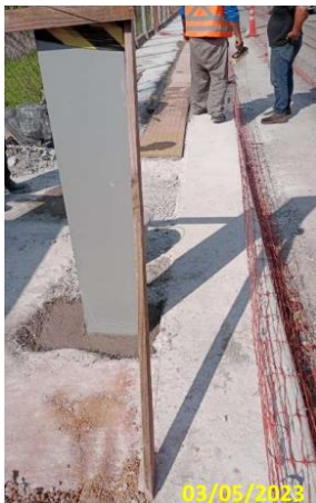
Foto 5 - Equipamento (totem) instalado na estaca 36, altura do nº 754 da avenida Doutor Américo de Figueiredo, sentido bairro.
