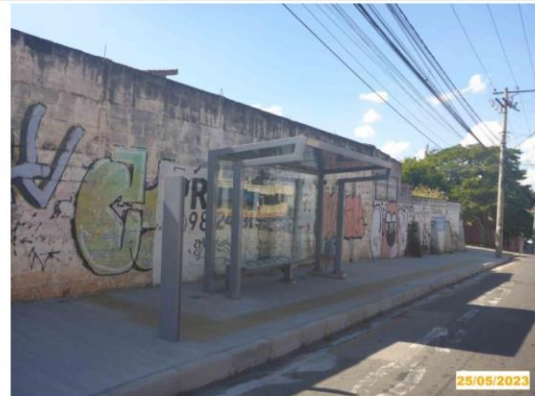
Foto 4 - Abrigo no ponto de parada na estaca 97, altura do número 1.223 da avenida em referência.
