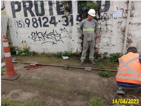
Foto 13 – Marcação das fundações do abrigo na estaca 97, altura do nº 1.991 da avenida Doutor Américo de Figueiredo, sentido bairro.
