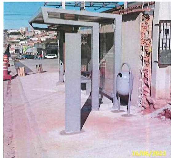
Foto 19 Vista lateral do conjunto instalado
