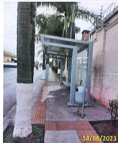
Foto 04 Vista lateral direita do conjunto instalado
