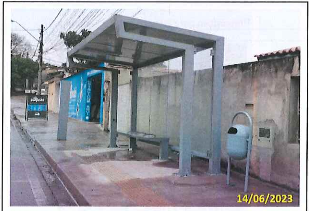
Foto 11 Vista do conjunto instalado
