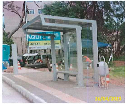
Foto 15 Vista do conjunto instalado
