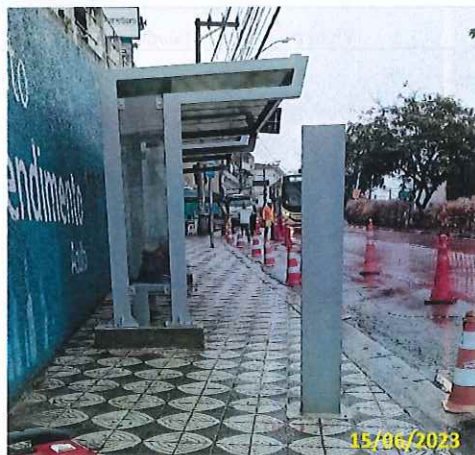
Foto 04 Vista lateral do conjunto instalado
