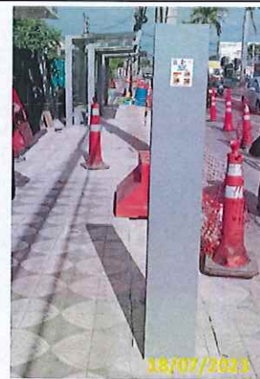
Foto 15 Vista lateral do conjunto instalado
