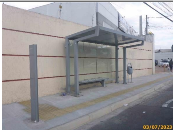
Foto 18 – Vista da parada de ônibus com os equipamentos em conformidade com o Anexo II de Edital. Estaca 75.
