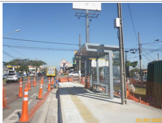
Foto 21 – Vista da parada de ônibus com os equipamentos em conformidade com o Anexo II de Edital. Estaca 130.
