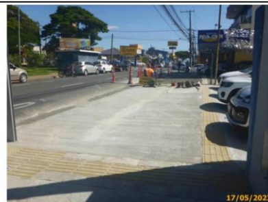
Foto 4 – Reforma do passeio em andamento na calçada da agência de automóveis. Sentido Bairro.
