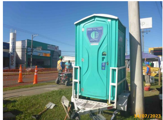
Foto 76 – Instalação sanitária disponibilizada na frente de obras.
