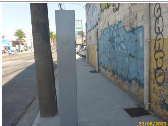
Foto 41 – Marco (totem) instalado.
