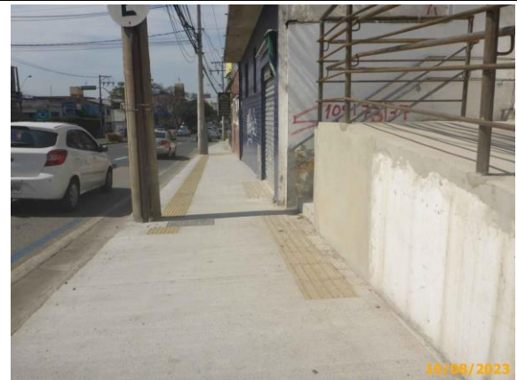
Foto 24 – Sinalização tátil de alerta (próxima a guia), e, direcional nos acessos de lindeiros.
