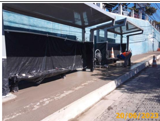
Foto 7 – Reforma do passeio em andamento, em destaque, o concreto aplicado no passeio.
