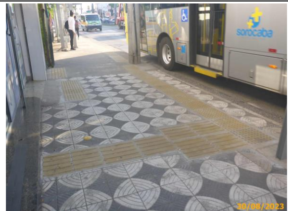
Foto 54 – Vista parcial da calçada em que foi mantido revestimento conforme acordado com o lindeiro. Em destaque, a sinalização tátil de alerta e direcional.
