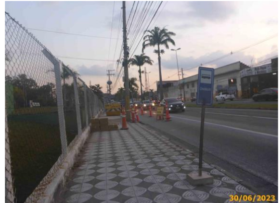
Foto 58 – Sinalização provisória durante as obras, e, em destaque, o ponto de parada do ônibus provisório.
