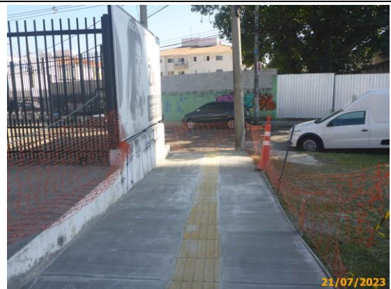
Foto 86 – Vista parcial do passeio após a aplicação do concreto. Em destaque, o piso tátil
