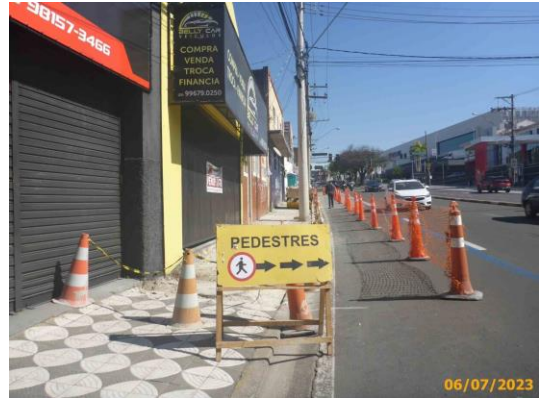
Foto 16 – Sinalização provisória das obras. Em destaque, a passagem de pedestres sentido bairro.
