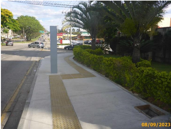
Foto 41 – Marco (totem) instalado.
