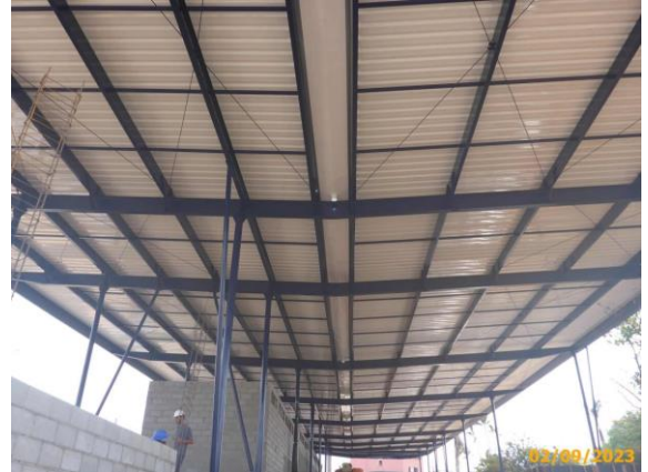
Foto 26 – Vista da cobertura concluída do Terminal. Em destaque a calha no eixo da cobertura.
