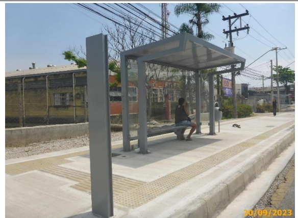
Foto 28 – Vista geral do mobiliário urbano implantado em conformidade com o Anexo II de Edital.
