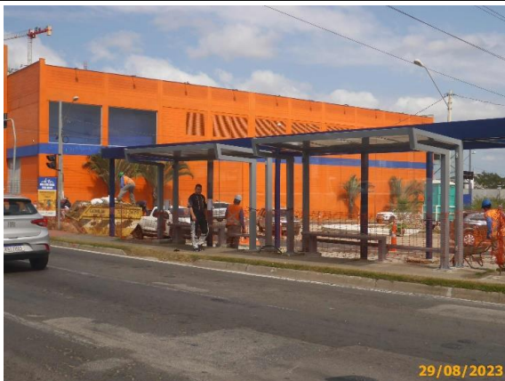
Foto 9 – Vista dos dois abrigos instalados no PP.
