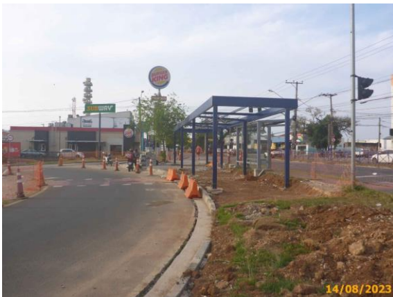
Foto 23 – Instalação dos pilares e vigas da estrutura metálica do abrigo da estação.
