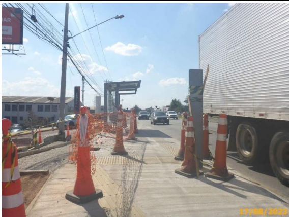
Foto 33 – Marco (totem) instalado.
