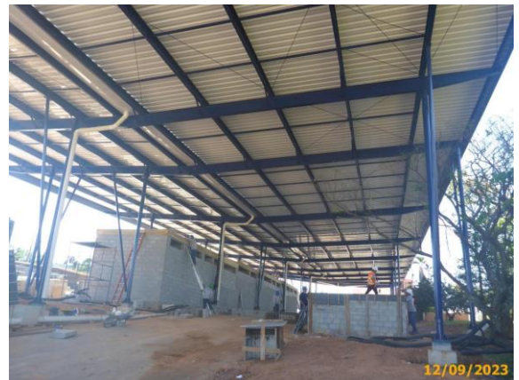
Foto 28 – Segue foto anterior. Em destaque, o sistema de drenagem pluvial da cobertura concluído.
