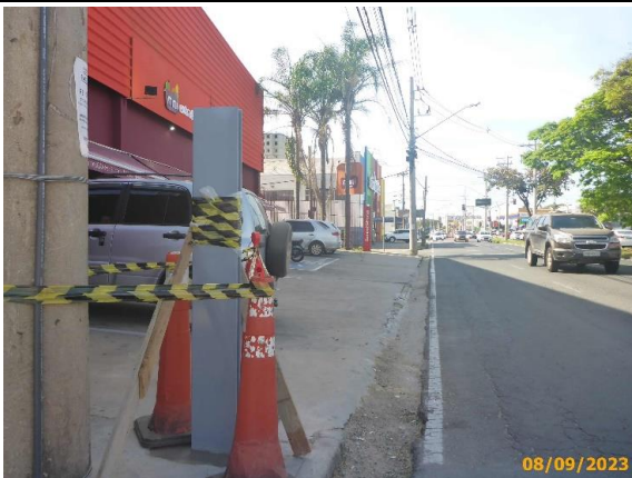
Foto 15 – Totem instalado no Ponto de Parada.
