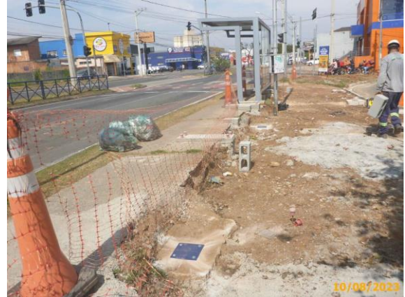
Foto 22 – Início da instalação dos marcos da estrutura metálica do abrigo da estação.
