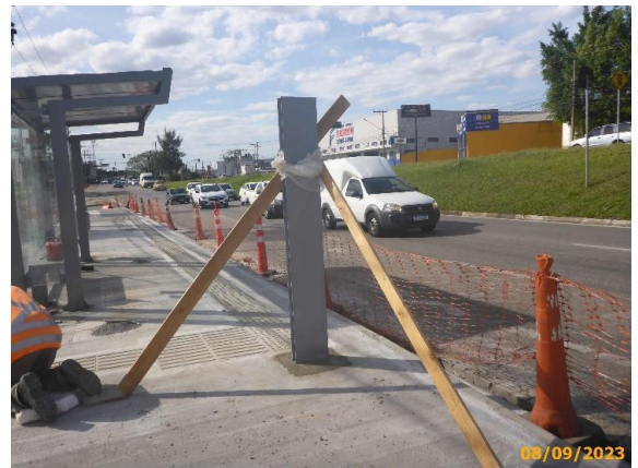
Foto 26 – Marco (totem) instalado.
