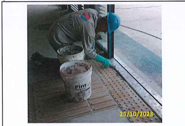
Foto 51 Rejunte entre o piso podotátil e a porta da estação
