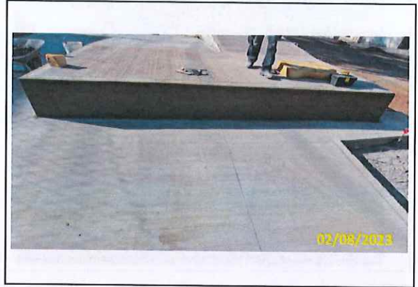
Foto 14 Reboco da rampa da estação
