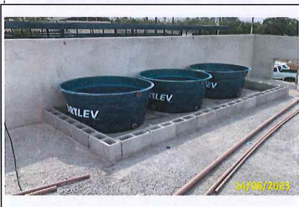
Foto 66 Caixa d' água da casa dos motoristas
