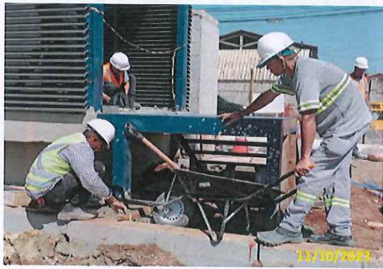
Foto 37 Chumbamento da escada da saída de emergência
