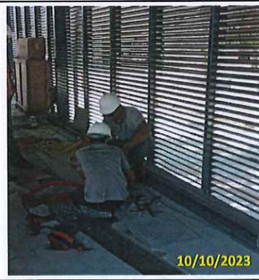
Foto 36 Dutos da porta e catraca da estação
