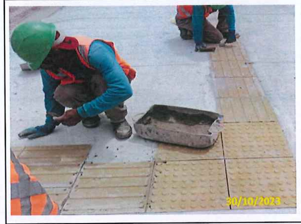
Foto 43 Rejunte de piso podotátil
