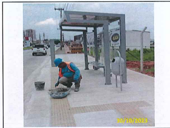
Foto 32 Rejunte de piso podotátil
