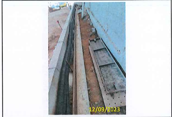
Foto 10 Passagem da tubulação de água - Cisterna
