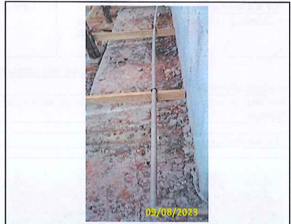
Foto 06 Ligação hidráulica - Água da rua e cisterna
