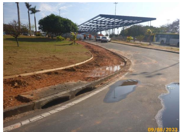
Foto 14 – Segue foto anterior. Detalhe do sistema de drenagem existente na via das Linhas Alimentadoras.
