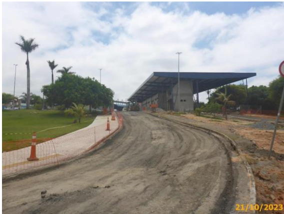
Foto 33 – Vista parcial da via das Linhas Alimentadoras, destacando as deflexões com necessidade de reconstrução.
