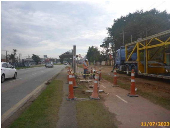
Foto 51 – Vista geral do Ponto de Parada antes das obras de reforma do passeio.
