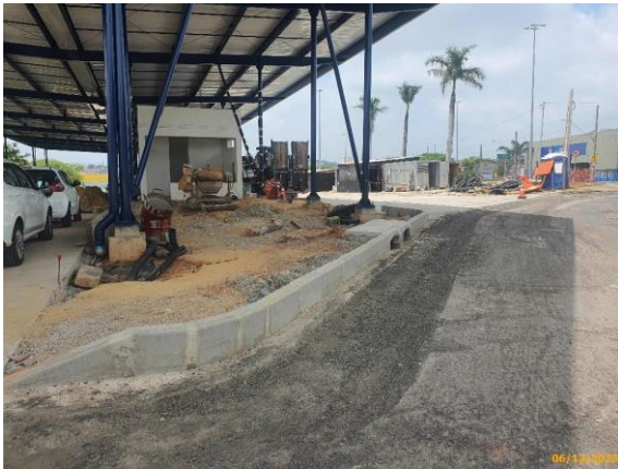
Foto 21 – Reconstrução da boca-de-lobo e instalação das guias junto a Área de Transferência.
