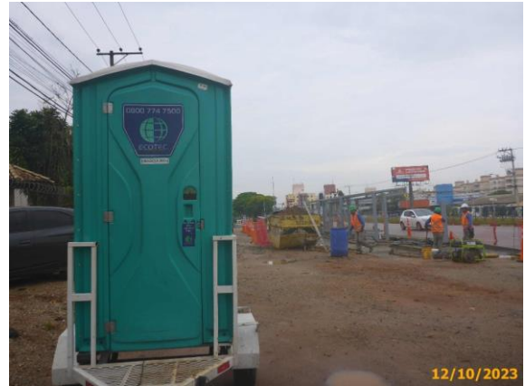
Foto 60 – Instalação sanitária disponibilizada na frente de obras.
