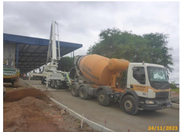
Foto 78 – Segue foto anterior. Bombeamento do concreto para a execução da via da Linha Eixo BRT.
