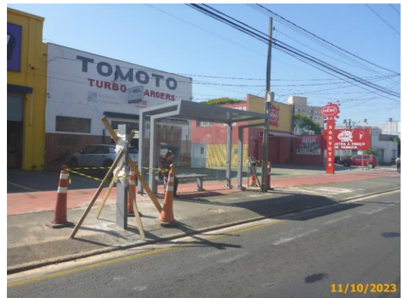
Foto 4 – Vista da parada, com os equipamentos urbanos instalados.
