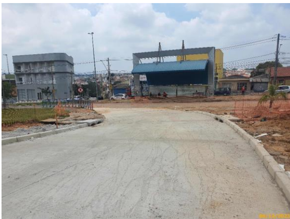
Foto 17 – Vista da via da Linha Eixo BRT, cujos sistemas de drenagem foram reconstruídos.
