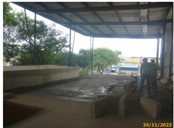
Foto 80 – Segue foto anterior. Uso da vassoura com fios de nylon para a execução das ranhuras no pavimento.
