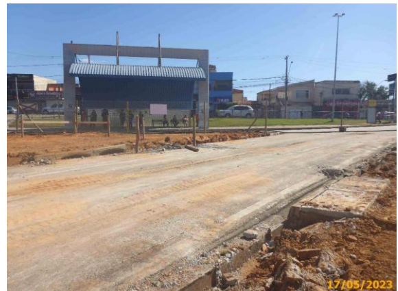
Foto 12 – Sistema de drenagem existente na Linha Eixo do BRT foi mantido.
