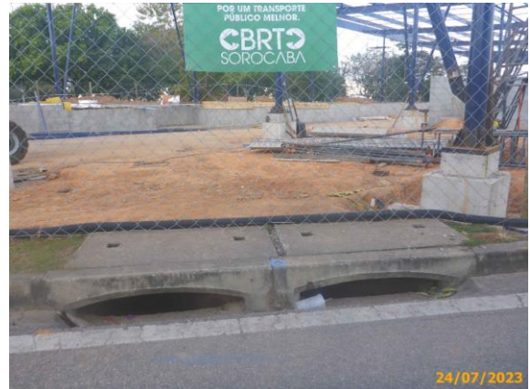
Foto 10 – Sistema de drenagem existente na atual Área de Transferência foi mantido.
