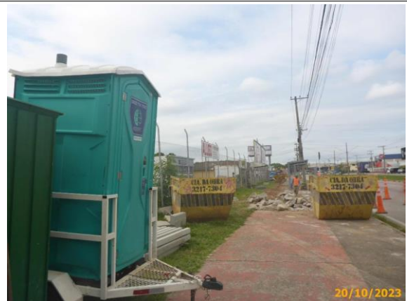
Foto 24 – Instalação sanitária disponibilizada na frente de obras.
