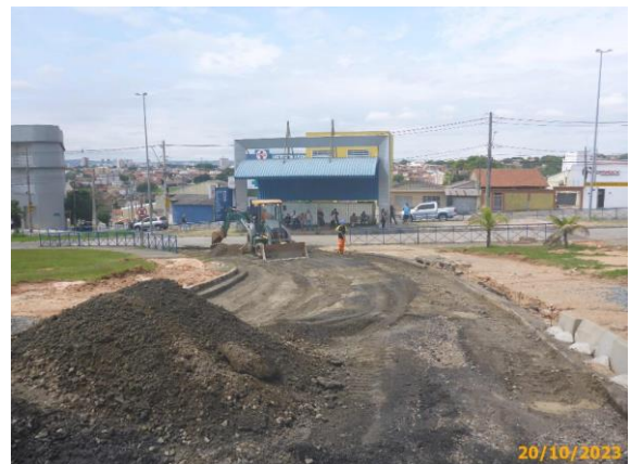
Foto 32 – Segue foto anterior. Base apresentou deflexões com necessidade de reconstrução.
