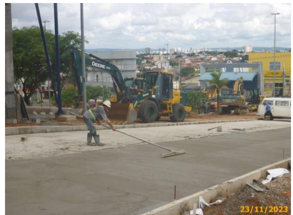
Foto 44 – Passagem da vassoura com fios de nylon para formar ranhuras na via das Linhas Alimentadoras.
