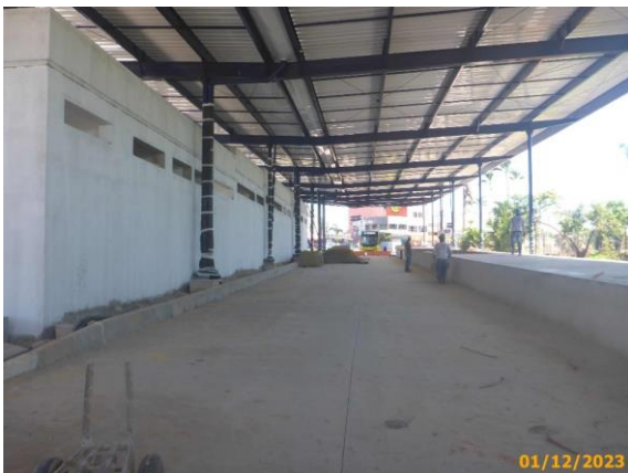
Foto 97 – Vista parcial do pavimento rígido da via da Linha Eixo BRT concluído.
