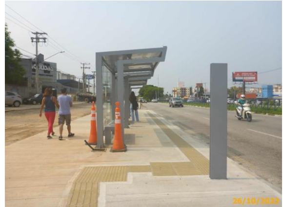
Foto 64 – Sinalização tátil implantada em conformidade com a NBR 16537.
