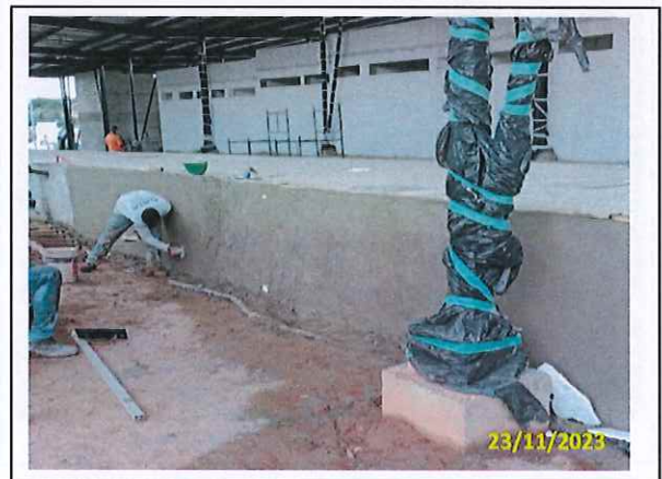
Foto 78 Reboco da plataforma
