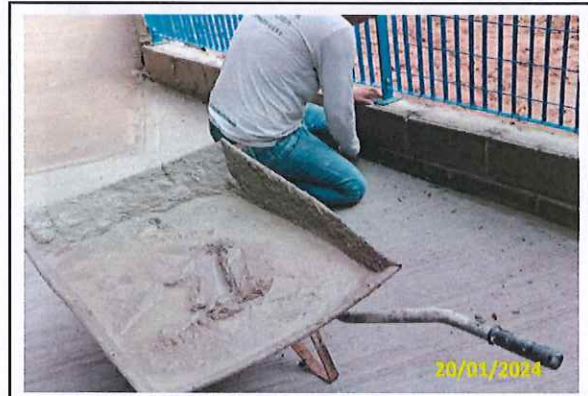
Foto 16 Enchimento entre a mureta e a calçada
