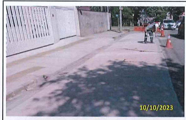
Foto 66 Acabamento entre o pav. rígido e flexível
