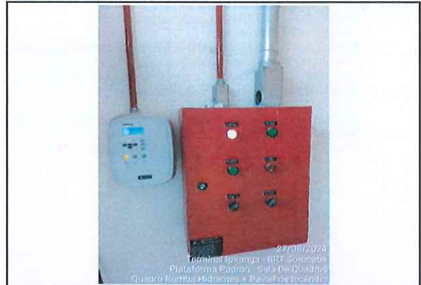
Foto 307 Quadro Bomba Hidrantes e painel de incêndio
