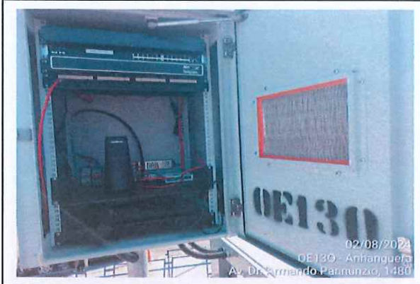
Foto 141 Interior do Rack Shelter e identificação
