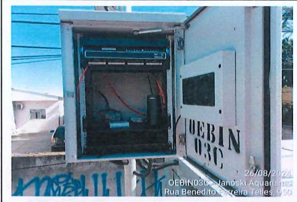
Foto 192 Interior do Rack Shelter e identificação
