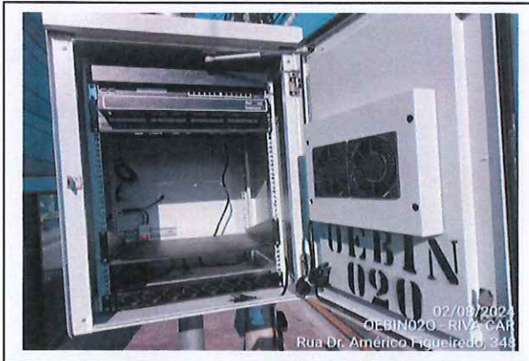
Foto 158 Interior do Rack Shelter e identificação
