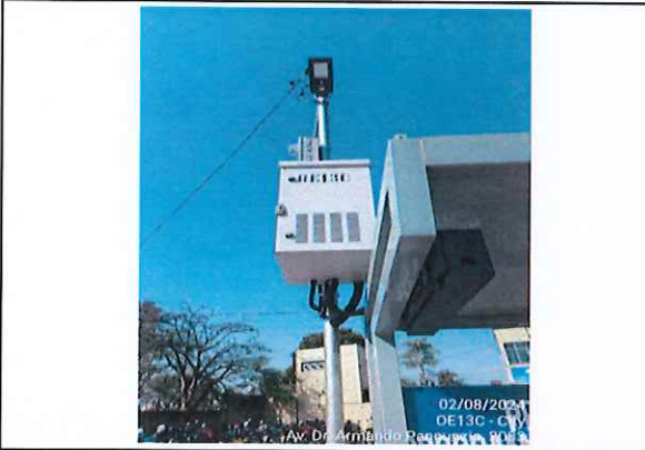
Foto 68 Vista poste, rack, luminária fotovoltaica e caixa simplificada
