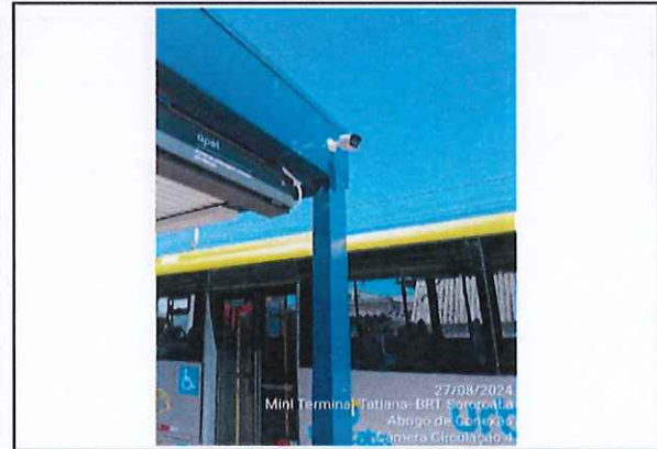
Foto 237 Abrigo de Conexão - Câmera de circulação 4
