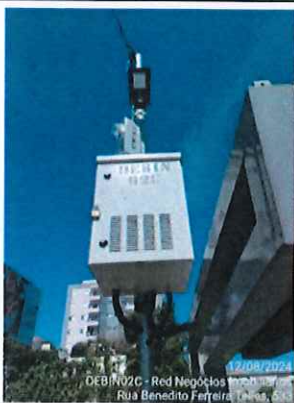
Foto 196 Vista poste, rack, luminária fotovoltaica e caixa simplificada
