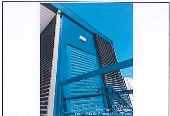
Foto 233 Luminária de emergência externa
