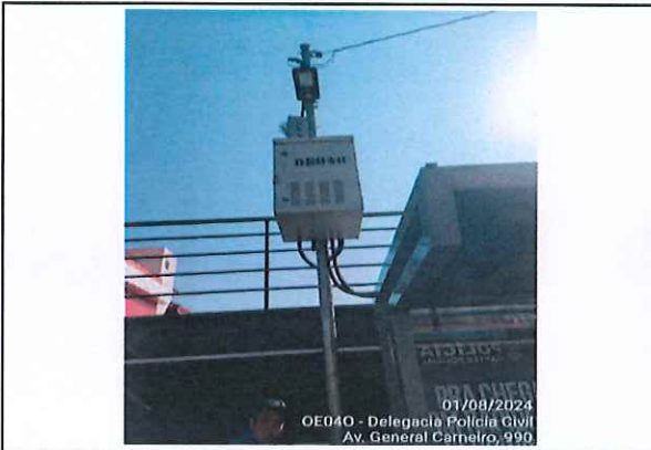
Foto 86 Vista poste, rack, luminária fotovoltaica e caixa simplificada
