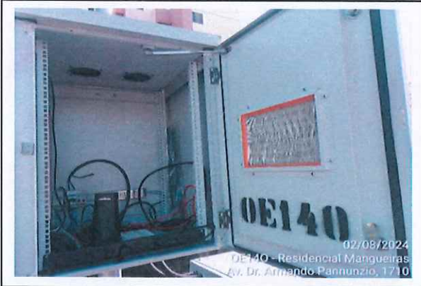
Foto 147 Interior do Rack Shelter e identificação
