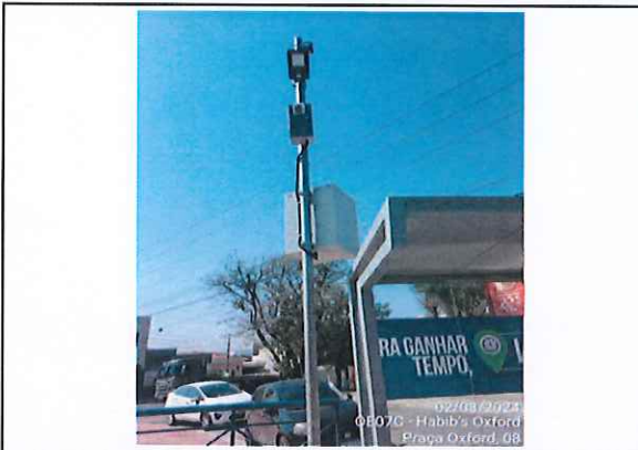
Foto 30 Vista poste, rack, luminária fotovoltaica e caixa simplificada
