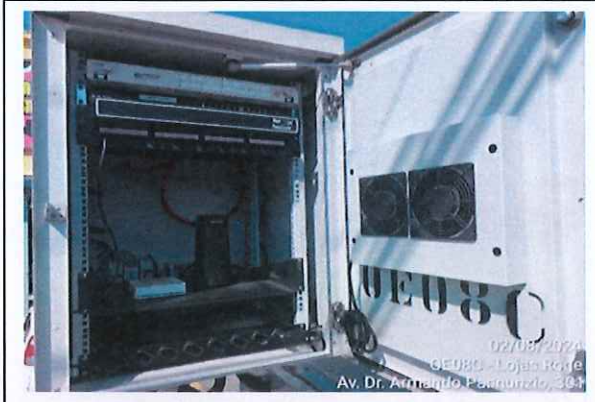
Foto 38 Interior do Rack Shelter e identificação
