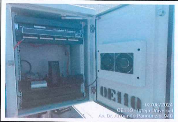
Foto 129 Interior do Rack Shelter e identificação
