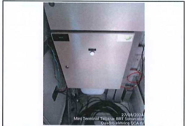
Foto 227 Quadro elétrico QCA-BI
