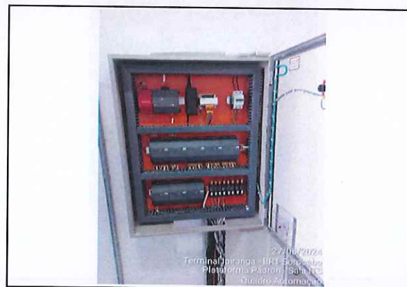
Foto 305 Quadro de automação - ITS
