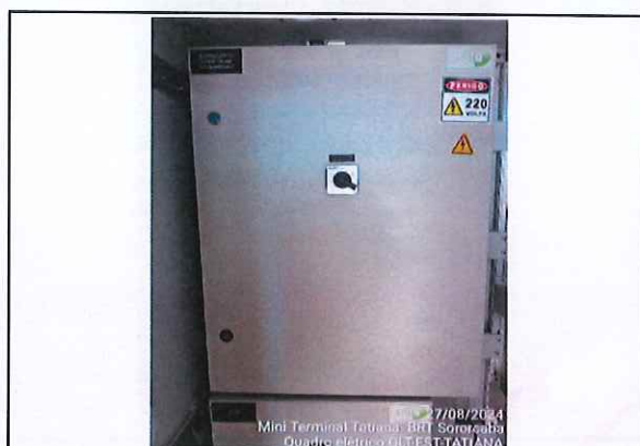
Foto 225 Quadro elétrico QLT
