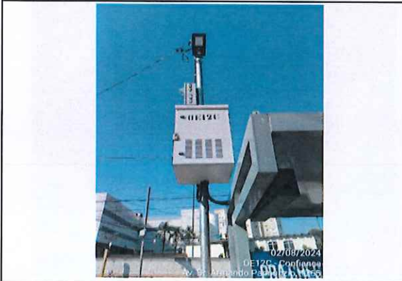
Foto 62 Vista poste, rack, luminária fotovoltaica e caixa simplificada
