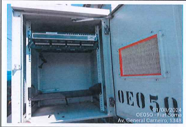
Foto 94 Interior do Rack Shelter e identificação
