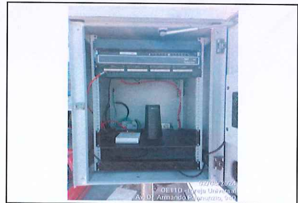
Foto 128 Interior do Rack Shelter
