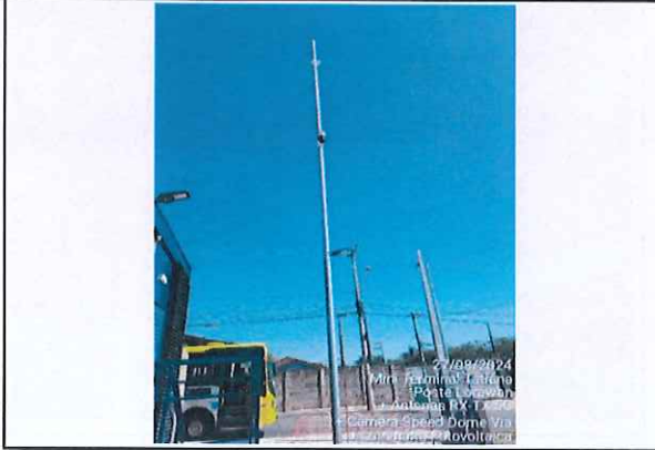
Foto 206 Vista poste, antena, câmera e luminária fotovoltaica
