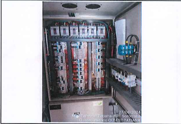
Foto 226 Quadro elétrico QLT
