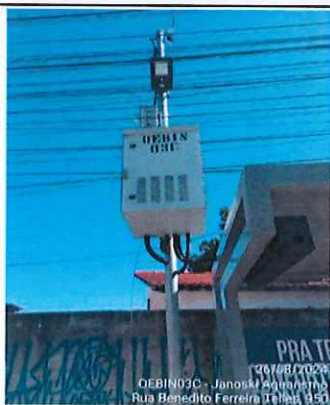
Foto 190 Vista poste, rack, luminária fotovoltaica e caixa simplificada
