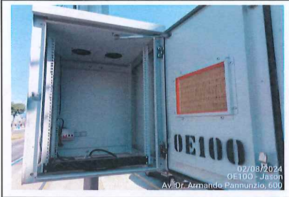
Foto 124 Interior do Rack Shelter e identificação
