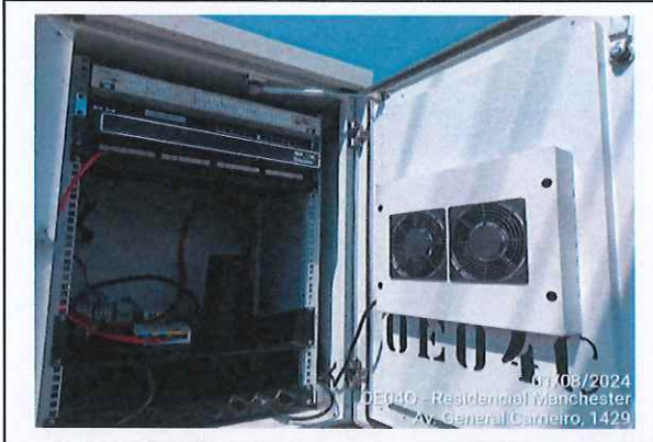
Foto 14 Interior do Rack Shelter e identificação
