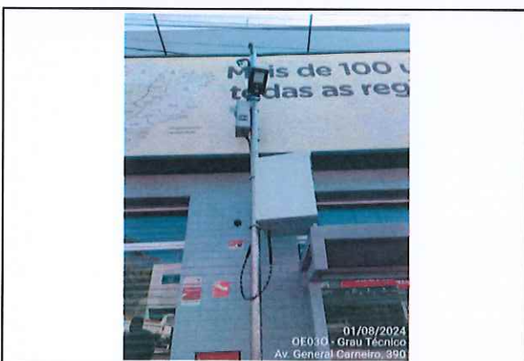
Foto 80 Vista poste, rack, luminária fotovoltaica e caixa simplificada
