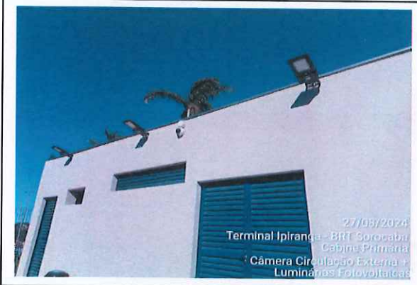
Foto 238 Câmera de circulação externa e luminárias fotovoltaicas
