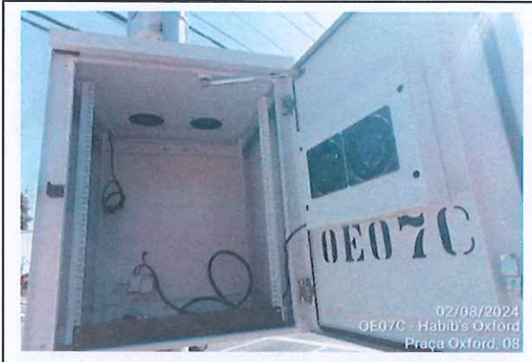
Foto 32 Interior do Rack Shelter e identificação
