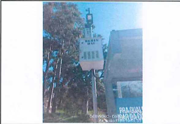
Foto 184 Vista poste, rack, luminária fotovoltaica e caixa simplificada
