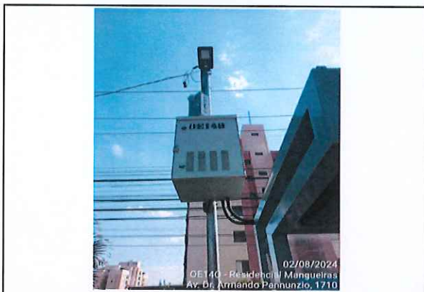
Foto 145 Vista poste, rack, luminária fotovoltaica e caixa simplificada
