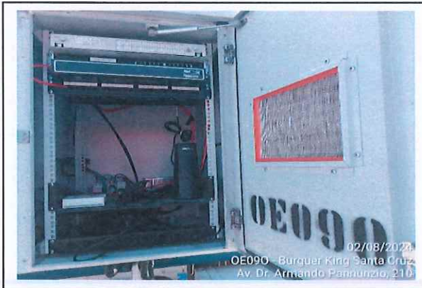
Foto 118 Interior do Rack Shelter e identificação
