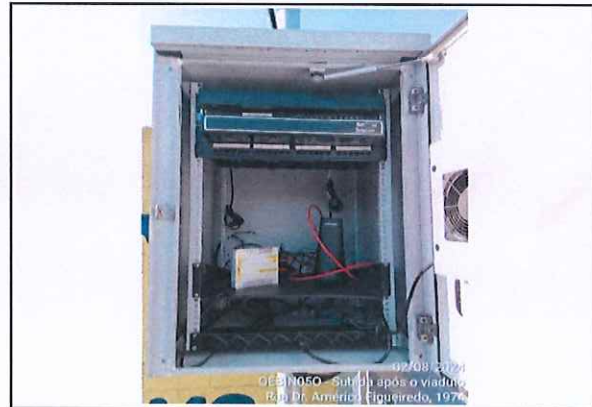
Foto 173 Interior do Rack Shelter
