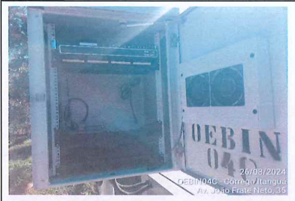
Foto 186 Interior do Rack Shelter e identificação
