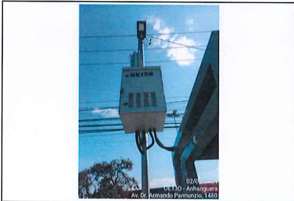
Foto 139 Vista poste, rack, luminária fotovoltaica e caixa simplificada
