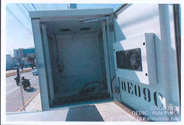
Foto 44 Interior do Rack Shelter e identificação
