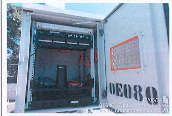
Foto 112 Interior do Rack Shelter e identificação
