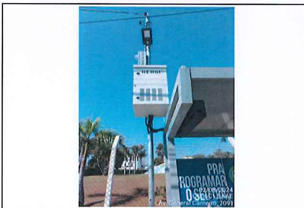
Foto 24 Vista poste, rack, luminária fotovoltaica e caixa simplificada
