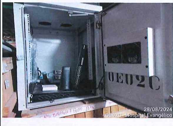
Foto 03 Interior do Rack Shelter identificado + acessórios disponíveis para instalação
