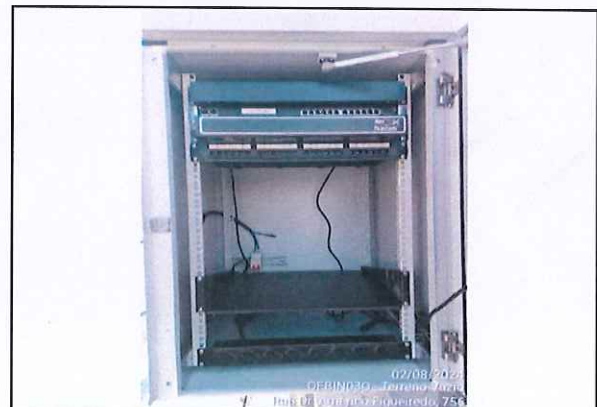
Foto 162 Interior do Rack Shelter
