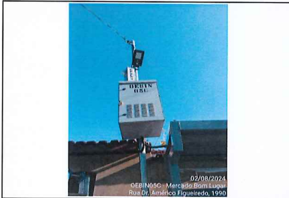
Foto 178 Vista poste, rack, luminária fotovoltaica e caixa simplificada
