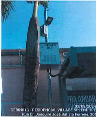
Foto 202 Vista poste, rack, luminária fotovoltaica e caixa simplificada
