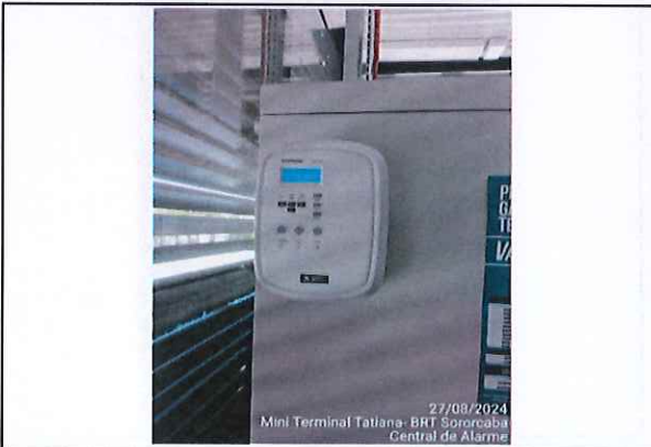
Foto 232 Central de alarme
