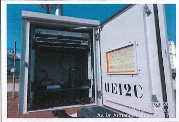
Foto 64 Interior do Rack Shelter e identificação
