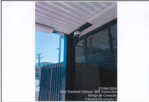
Foto 236 Abrigo de Conexão - Câmera de circulação 3
