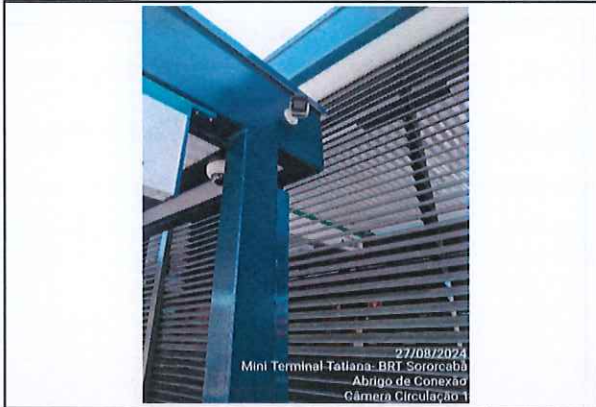
Foto 234 Abrigo de Conexão - Câmera de circulação 1
