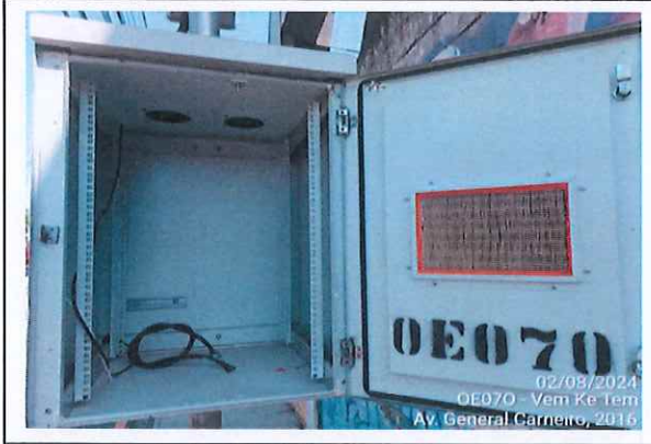
Foto 107 Interior do Rack Shelter e identificação
