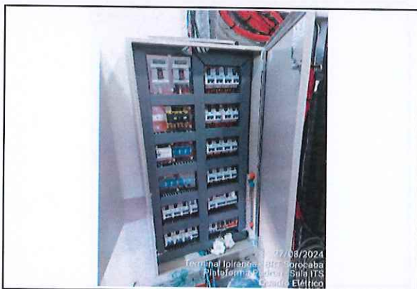
Foto 304 Quadro elétrico - ITS
