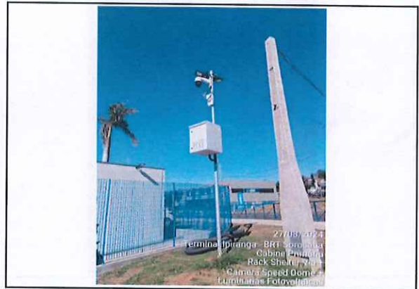
Foto 239 Rack Shelter, câmera Speed e luminárias fotovoltaicas
