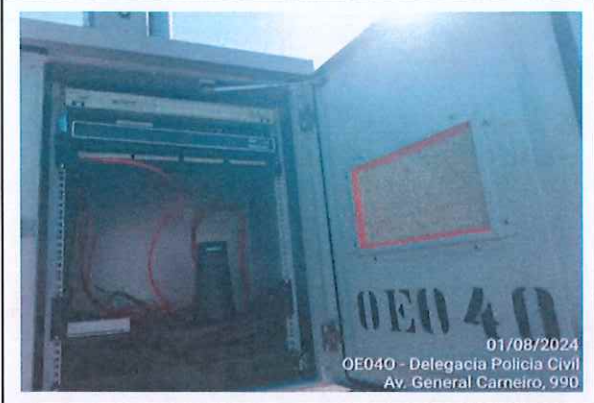
Foto 88 Interior do Rack Shelter e identificação
