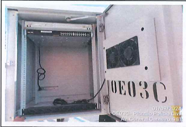
Foto 09 Interior do Rack Shelter e identificação
