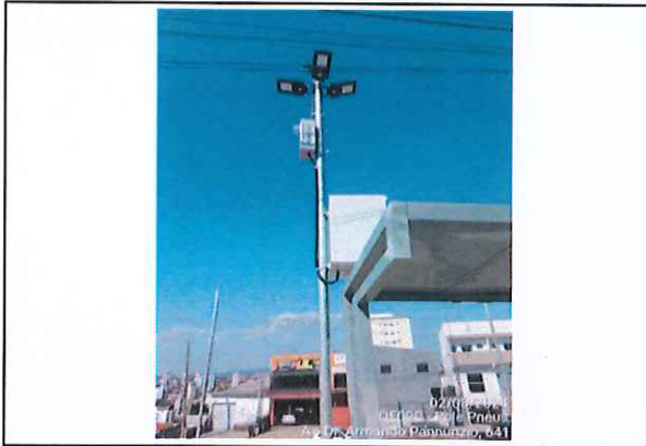
Foto 42 Vista poste, rack, luminária fotovoltaica e caixa simplificada
