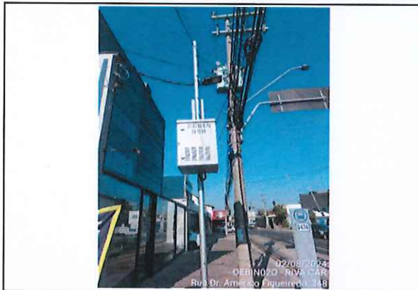
Foto 156 Vista poste, rack, luminária fotovoltaica e caixa simplificada
