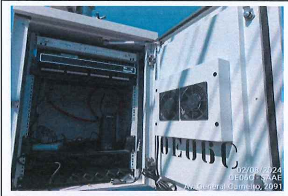
Foto 26 Interior do Rack Shelter e identificação
