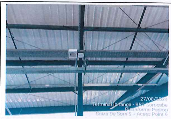
Foto 272 Caixa de som 5 e Access Point 6
