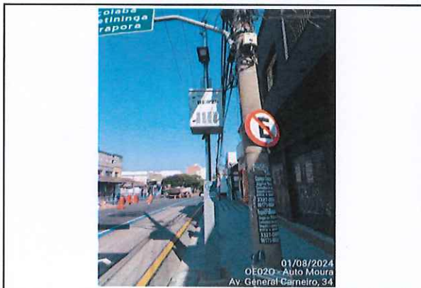
Foto 75 Vista poste, rack, luminária fotovoltaica e caixa simplificada
