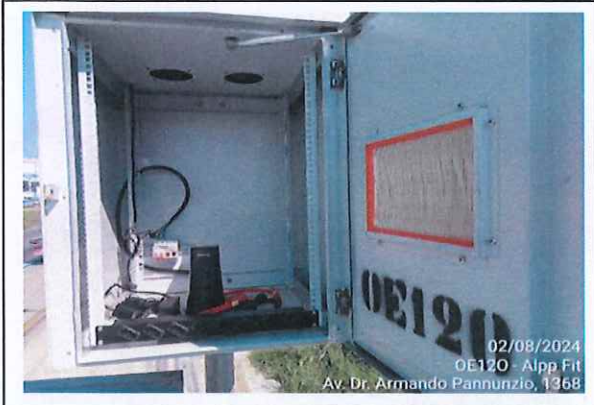
Foto 135 Interior do Rack Shelter e identificação
