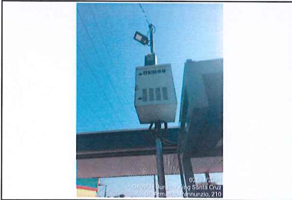
Foto 116 Vista poste, rack, luminária fotovoltaica e caixa simplificada
