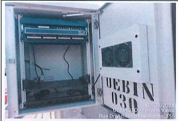
Foto 163 Interior do Rack Shelter e identificação
