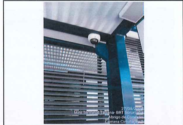
Foto 235 Abrigo de Conexão - Câmera de circulação 2
