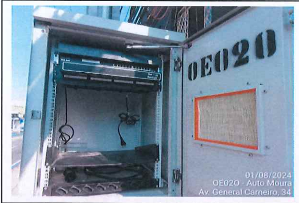
Foto 77 Interior do Rack Shelter e identificação
