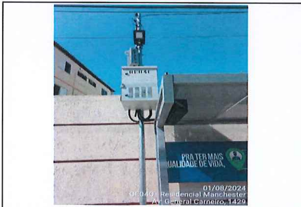
Foto 12 Vista poste, rack, luminária fotovoltaica e caixa simplificada
