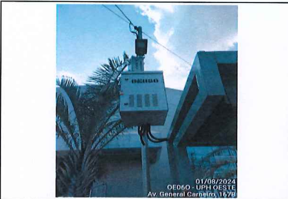
Foto 97 Vista poste, rack, luminária fotovoltaica e caixa simplificada
