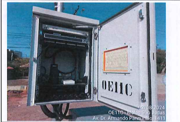
Foto 56 Interior do Rack Shelter e identificação
