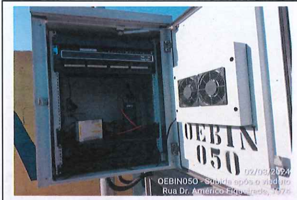
Foto 174 Interior do Rack Shelter e identificação
