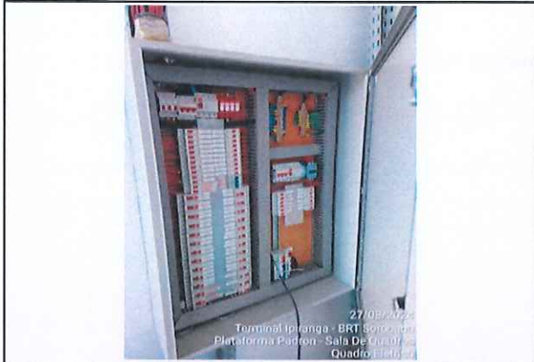
Foto 306 Quadro elétrico - Sala de Quadros
