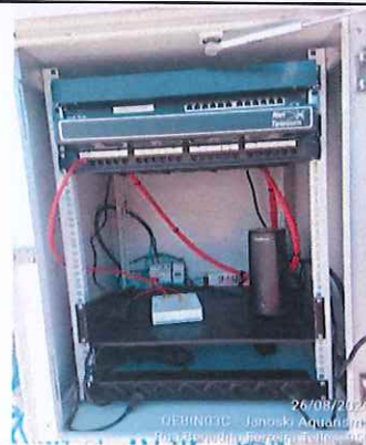
Foto 191 Interior do Rack Shelter
