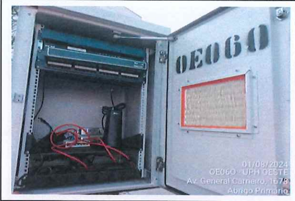
Foto 99 Interior do Rack Shelter e identificação
