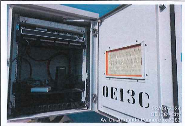
Foto 70 Interior do Rack Shelter e identificação
