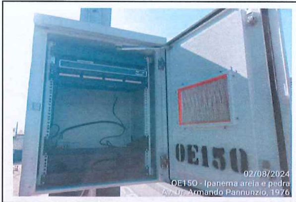
Foto 153 Interior do Rack Shelter e identificação
