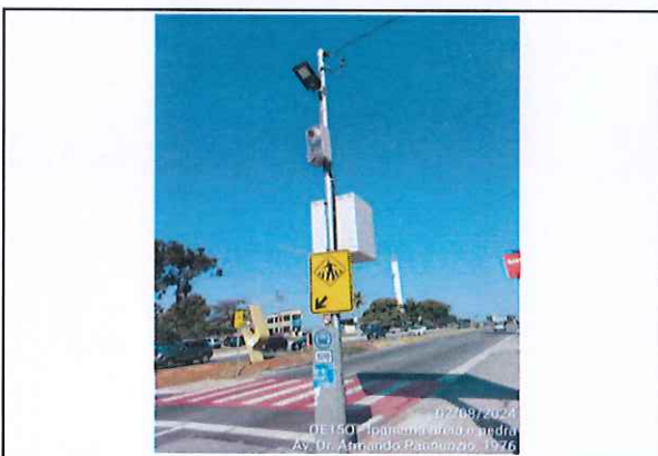
Foto 151 Vista poste, rack, luminária fotovoltaica e caixa simplificada
