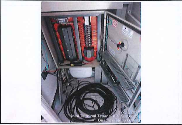
Foto 228 Quadro elétrico QCA-BI
