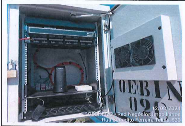
Foto 198 Interior do Rack Shelter e identificação
