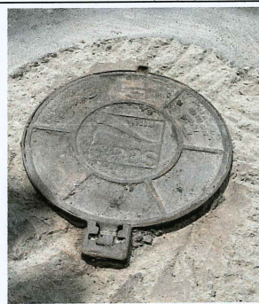
Levantamento de Tampão Rua A. Scudeler
