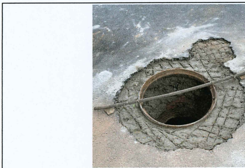
Levantamento de Tampão Rua A. Scudeler
