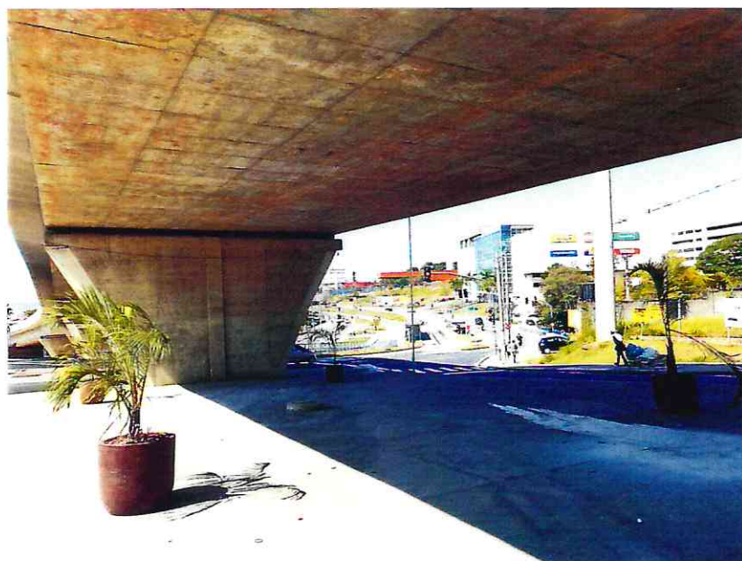
Foto 38 - Ponto de gotejamento de água no caixão perdido, entre o P1 e P2.
