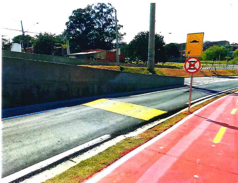
Foto 20 - Sinalização horizontal incompleta.
