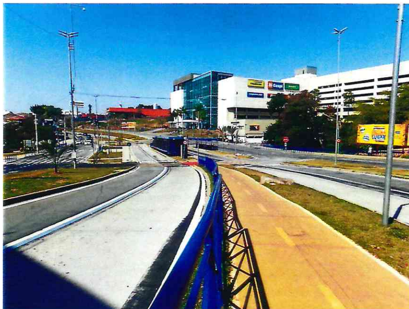
Foto 34 - Gradil desalinhado e mal instalado.
