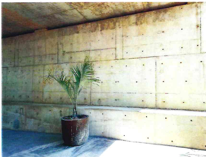
Foto 37 - Ponto de gotejamento de água no caixão perdido, entre o P1 e P2 no alçapão.
