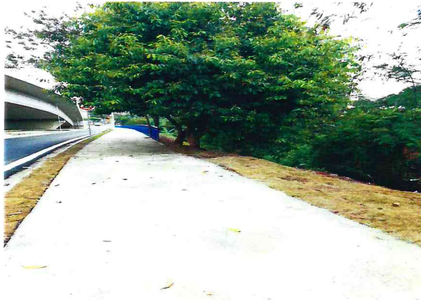
Foto 24 - Ausência de gradil neste trecho da ciclovia.
