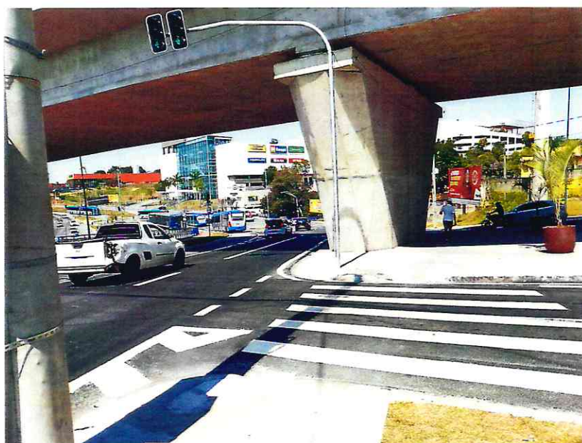
Foto 10 - Ausência de piso tátil nas rampas de acessibilidade e a não existência de semáforo para pedestre.
