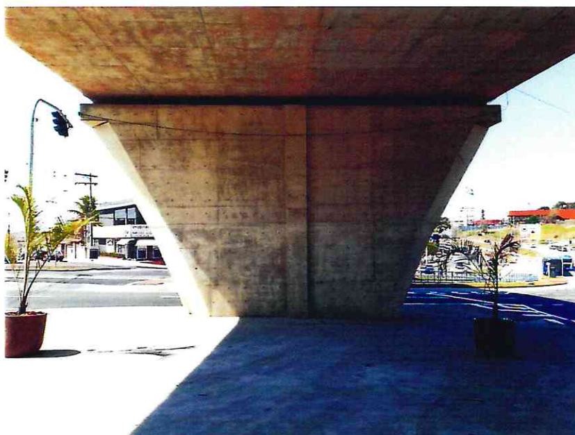
Foto 27 - Cabos aparentes e mal tensionados.
