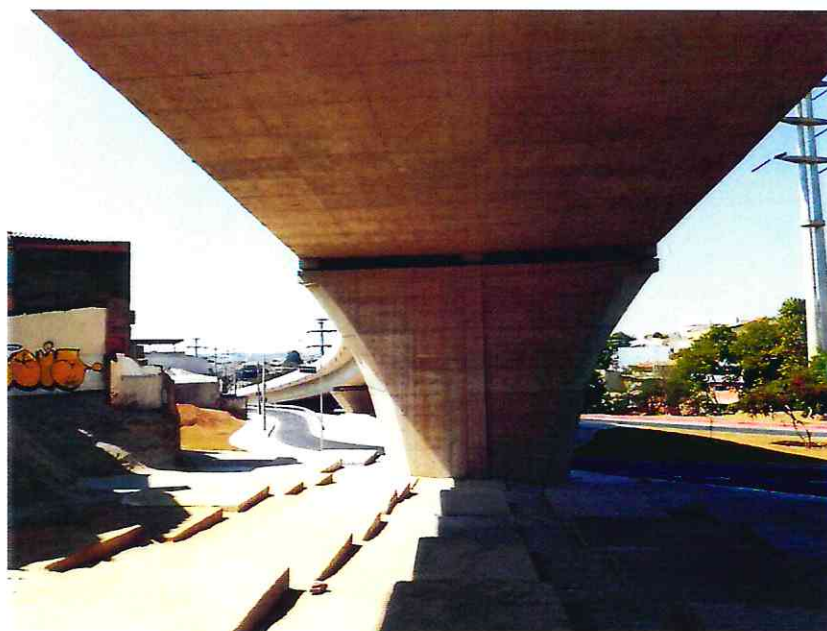
Foto 29 - Ponto de gotejamento de água no caixão perdido, entre o P3 e P4.
