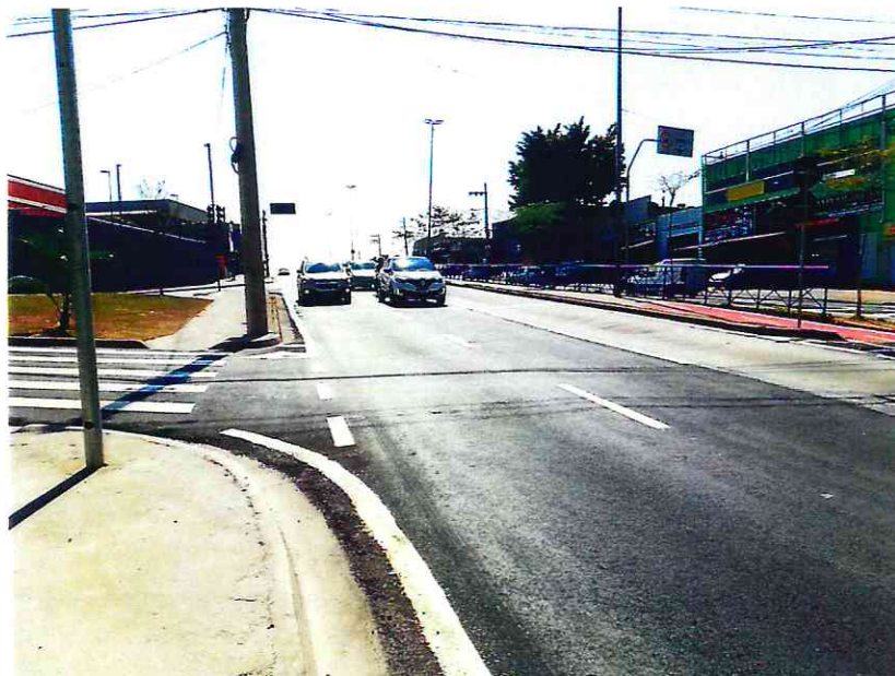
Foto 08 - Pintura horizontal mal executada.
