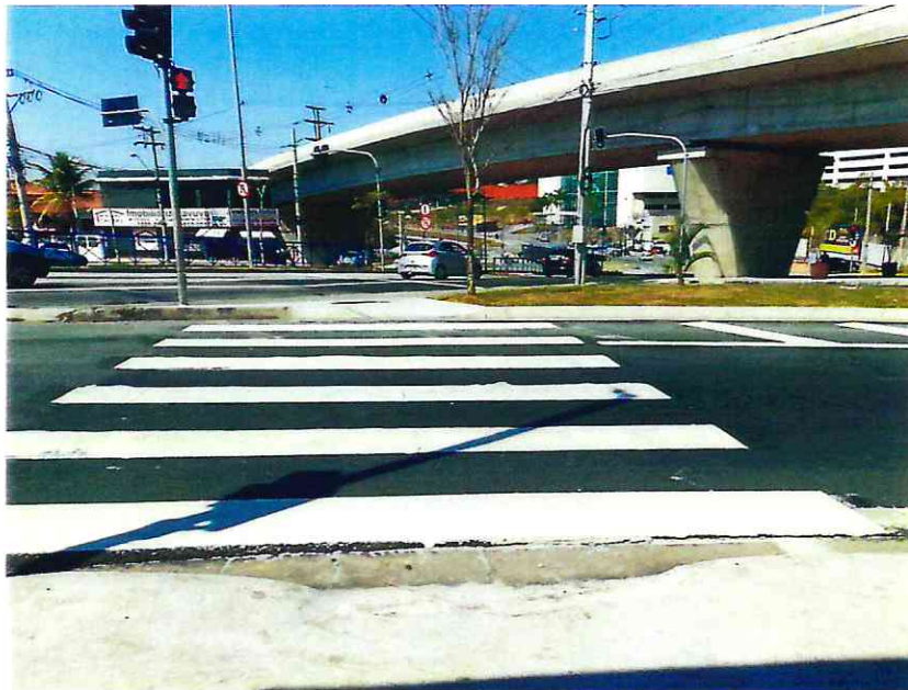
Foto 33 - Ausência de piso tátil nas rampas de acessibilidade e a não existência de semáforo para pedestre.
