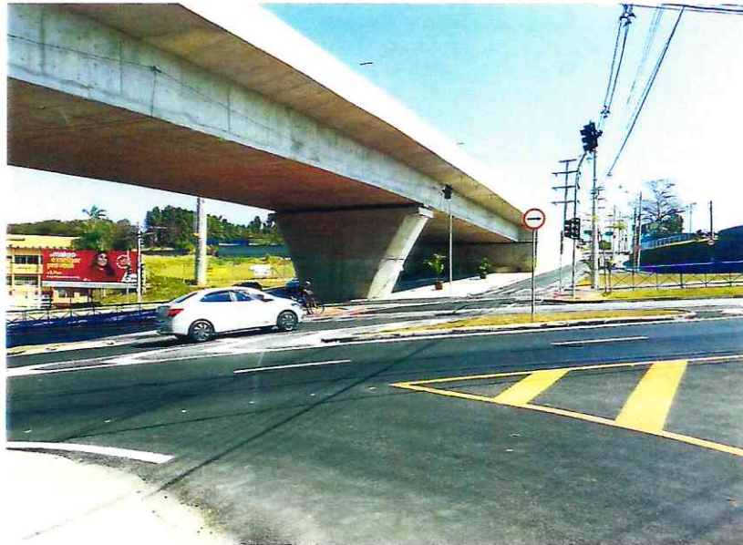
Foto 14 - Ausência de tachão na faixa zebraada branca, em frente ao canteiro.
