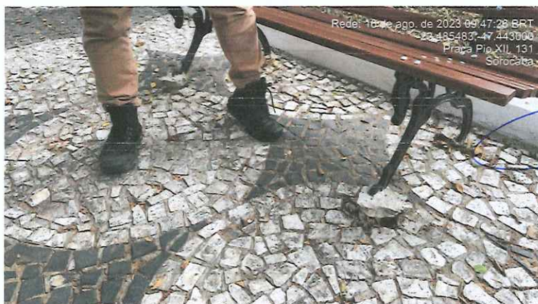
Foto 3 – Correção em fixação dos bancos novos de madeira
