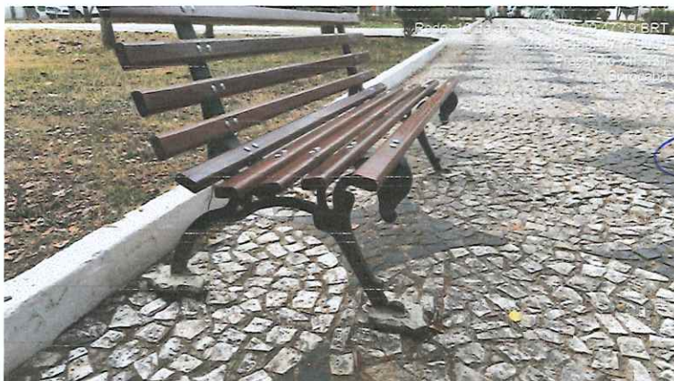
Foto 2 – Correção em fixação dos bancos novos de madeira
