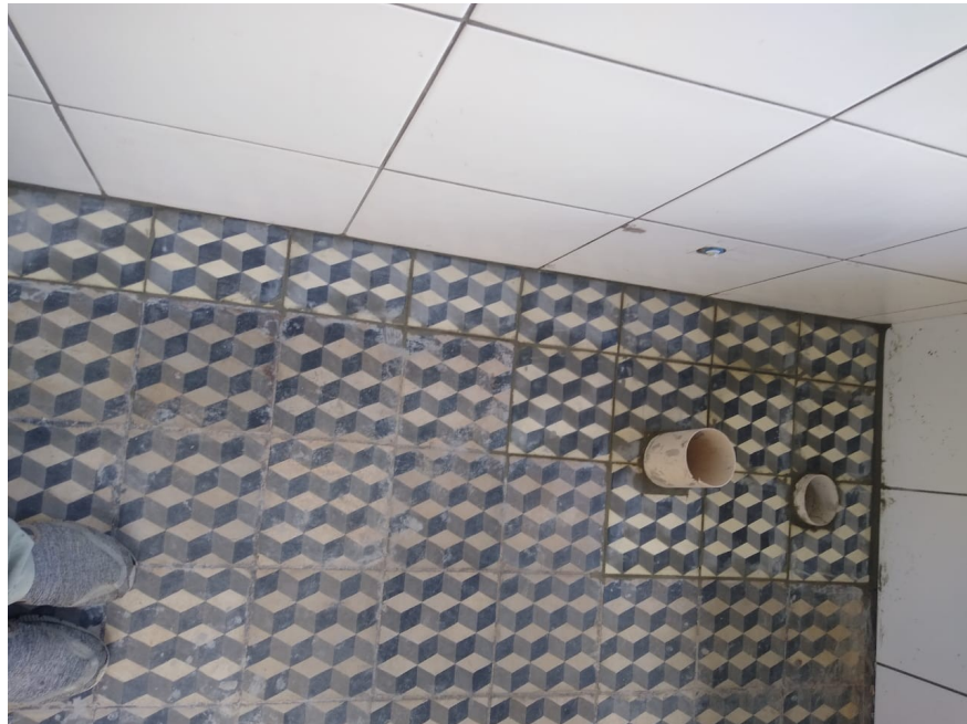
Foto 90: Réplicas do piso hidráulico do banheiro PNE;
