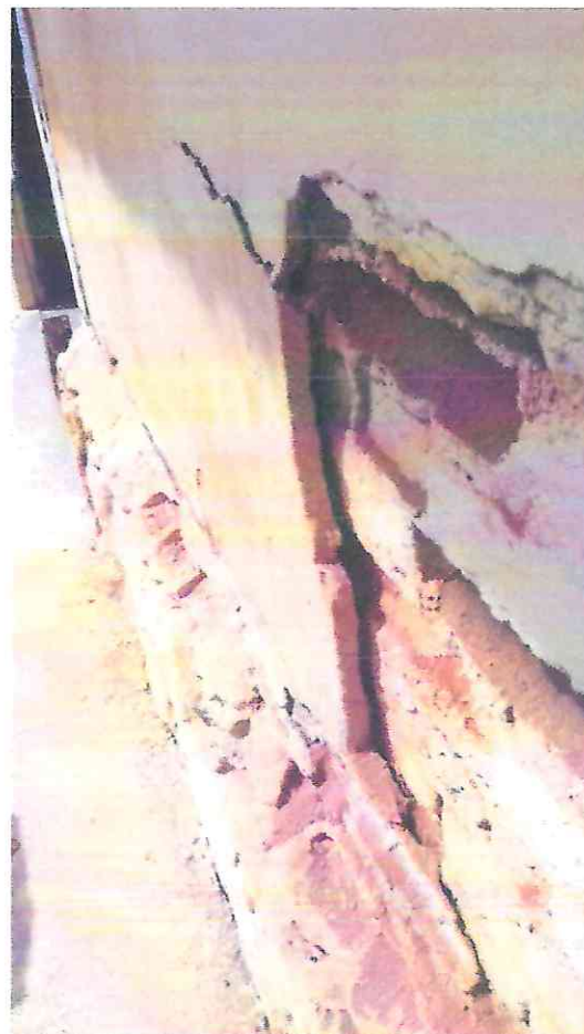
Foto 21: Detalhe das argamassas soltas.
