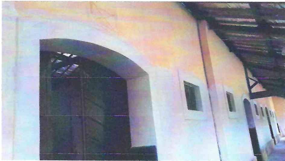
Foto 35: Detalhe da retirada das argamassas na obra bem superiores ao projeto vide foto 34.
