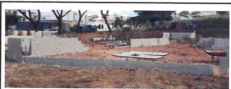
87473 - ALVENARIA DE VEDAÇÃO DE BLOCOS CERÂMICOS FURADOS NA VERTICAL DE 14X19X39CM (ESPESSURA 14CM) DE PAREDES COM ÁREA LÍQUIDA MENOR QUE 6M² SEM VÃOS E
