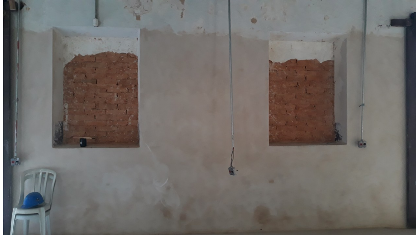
Foto 24: Chapisco, emboço e reboco prontos com argamassa especial conforme detalhamento do projeto.
