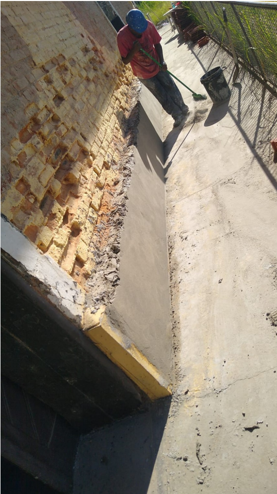
Foto 18: Barramento nas fachadas exteriores com argamassa conforme projeto e limpeza contínua na obra.
