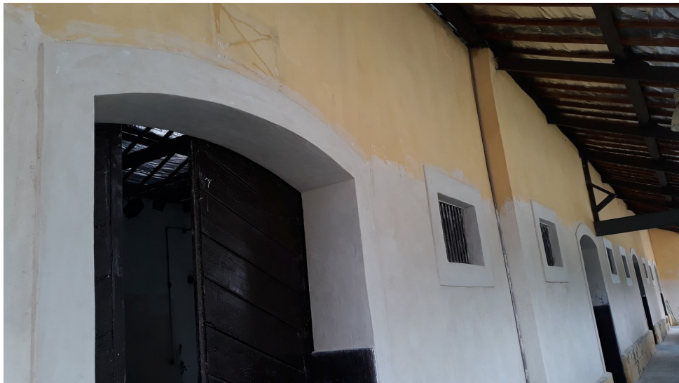
Foto 35: Detalhe da retirada das argamassas bem superiores ao projeto vide foto 34.
