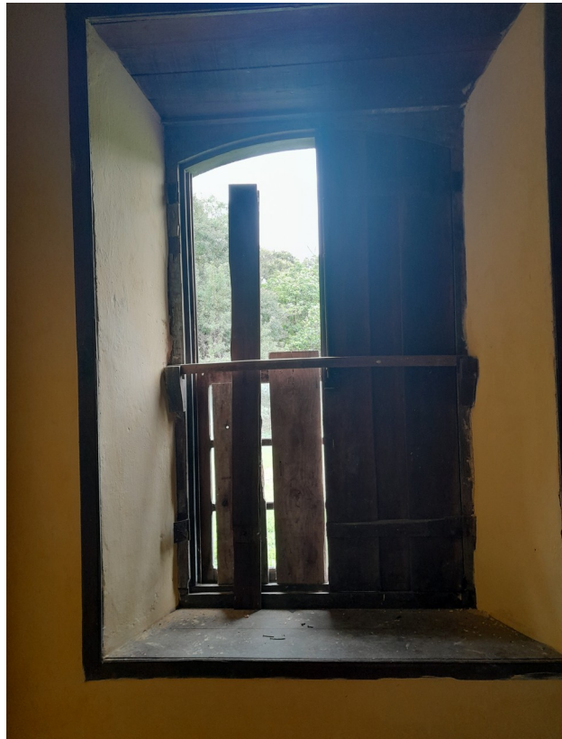
Foto 81: Detalhe da janela quebrada da fachada posterior.
