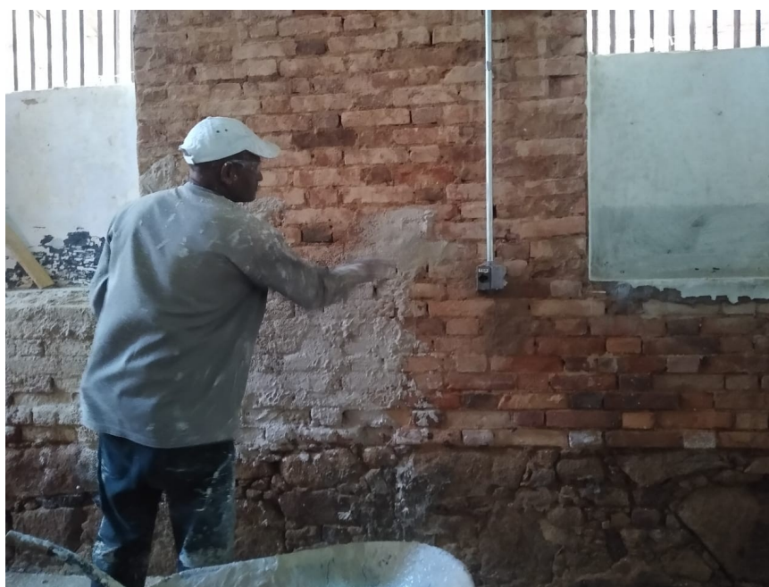
Foto 23: Chapisco das paredes internas com argamassa especial de areia e cal conforme especificações do projeto.
