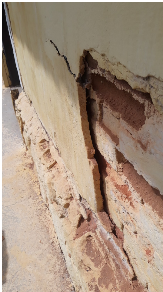
Foto 21: Detalhe das argamassas soltas.
