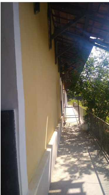
Foto 37: Detalhe das argamassas novas na fachada posterior, passando da altura das portas, bem acima da projeção da foto 36.
