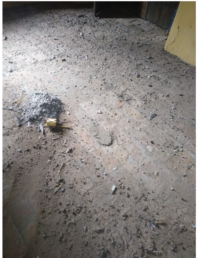
Foto 75: Detalhe das sujidades encontradas no interior do Casarão antes do início dos serviços.
