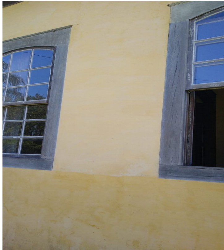
Foto 73: Detalhe da pintura nova com a antiga.
