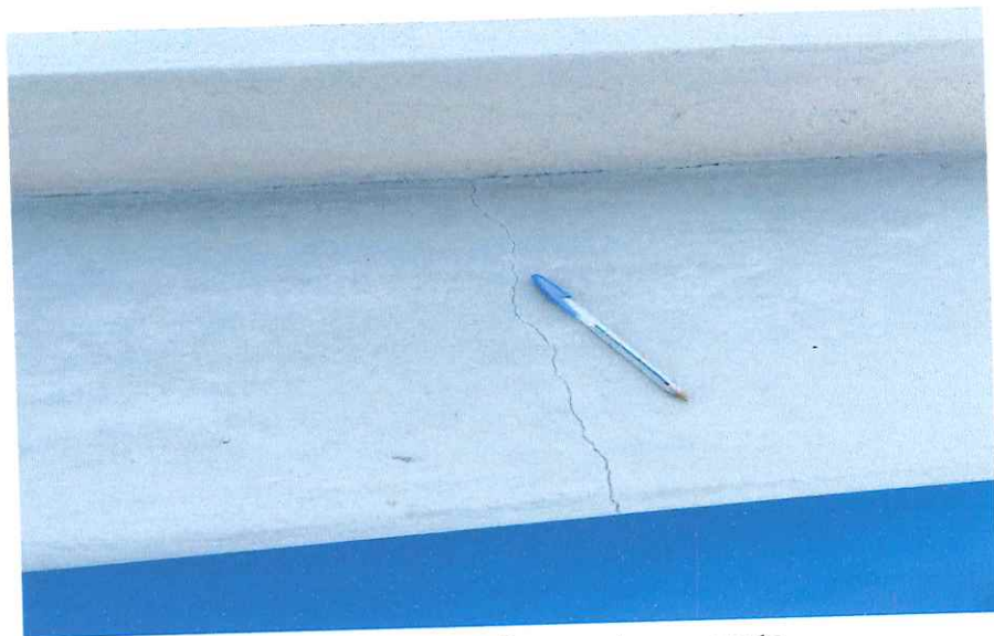
Foto 2: Trinca no banco de concreto
