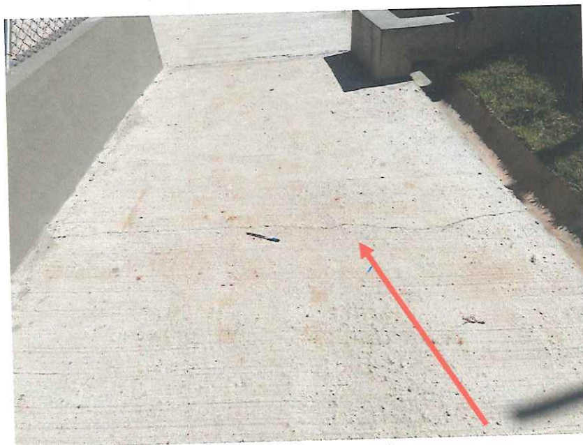
Foto 5: Trinca no passeio
