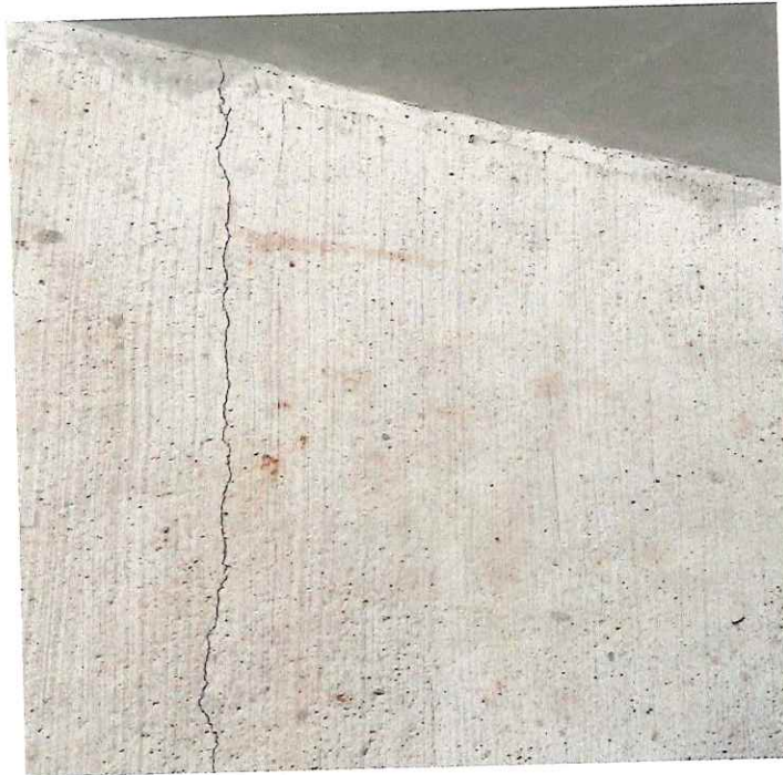
Foto 4: Trinca no passeio
