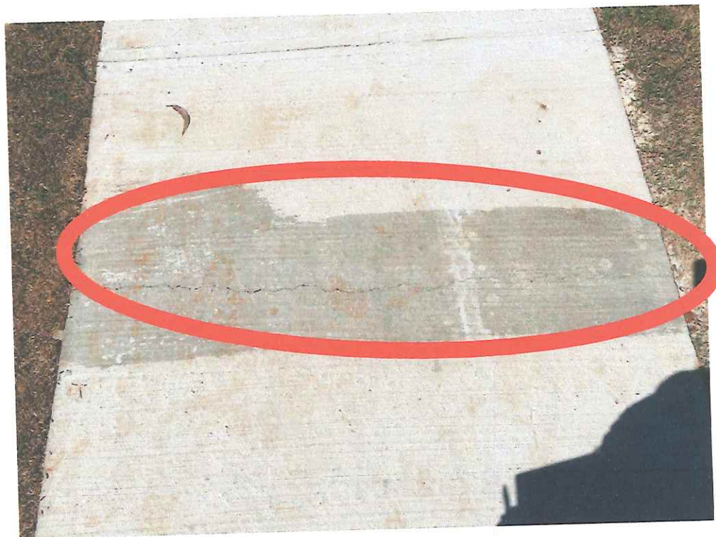
Foto 3: Trinca no passeio
